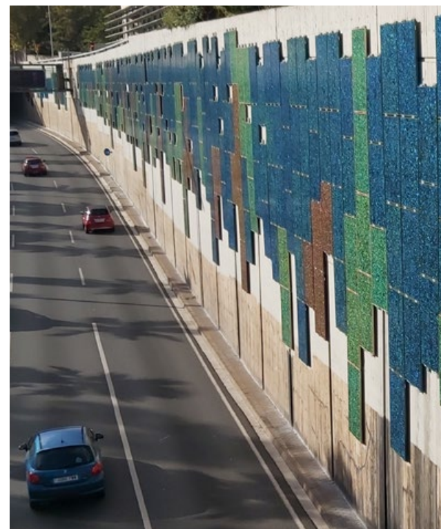
Instal·lació fotovoltaica murs Rda. de Dalt
